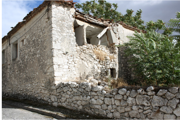
Casa parroquial abandonada en Fuentes de Cuéllar (Segovia). No hay curas, porque determinadas leyes históricas se absolutizaron: los presbíteros no han de estar casados y ser varones.
